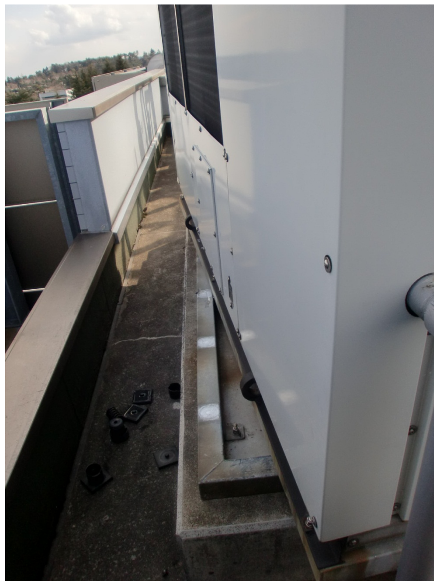
↑支持しているダンパが破損し、移動・故障した空冷チラー
