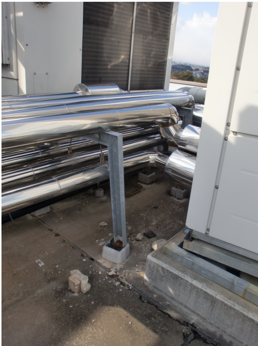
↑支柱が破損し、歪んだ冷温水パイプ
